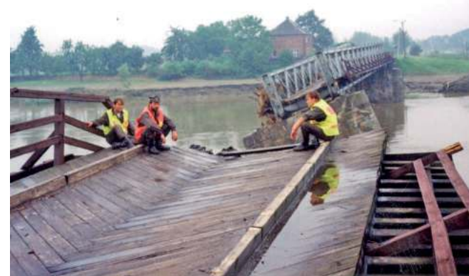
Strażacy odbywali dyżury m.in. przy zniszczonym przez wielką wodę moście w Krzyżanowicach
