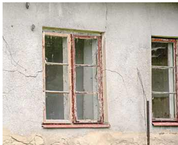
Budynek wymaga kapitalnego remontu
