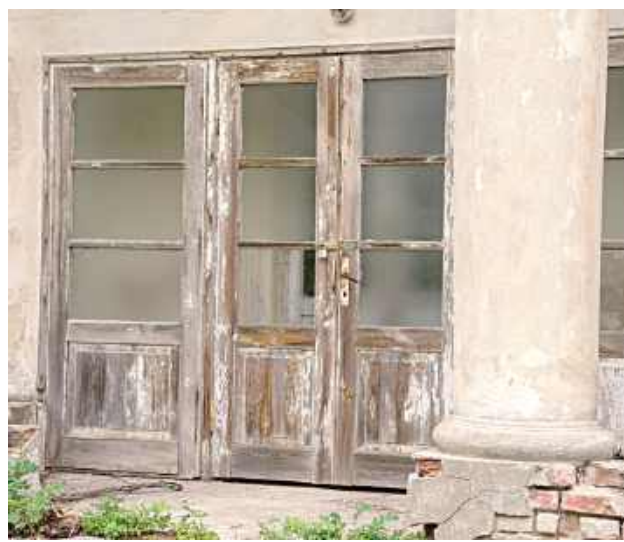
Po budynku widać upływ czasu
