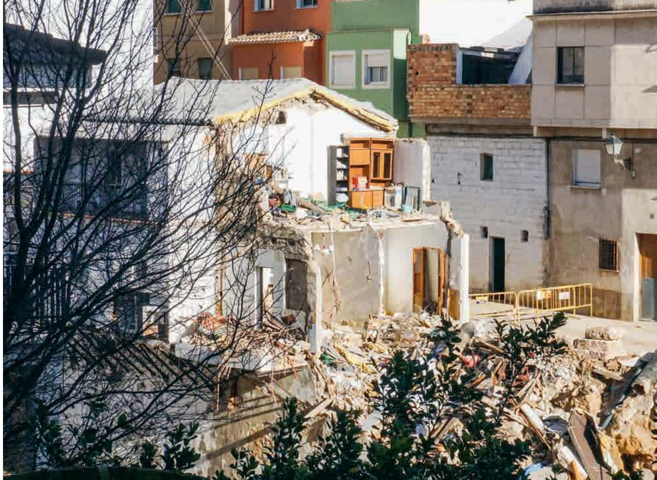
Wiele budynków po przejściu fali powodziowej nadaje się tylko do wyburzenia. Chiva, Hiszpania, styczeń 2025 r.
