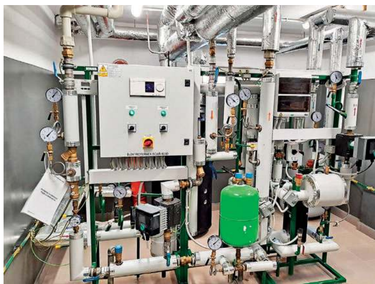
Indywidualny kompaktowy węzeł cieplny ul. Armii Krajowej
