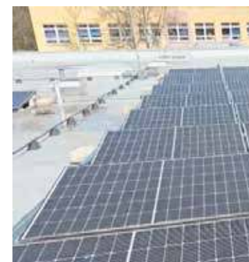
Panele fotowoltaiczne na dachu Przedszkola Miejskiego im. Krasińskiej Hałabały
