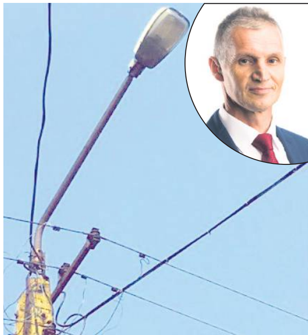
Stare oświetlenie to przeszłość. Zastąpiło go energooszczędne.
