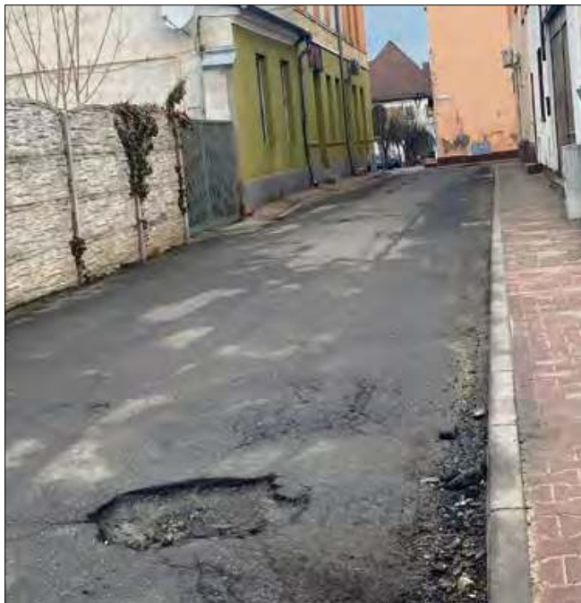
Dziura na ulicy Basztowej w pobliżu krapkowickiego rynku jest ogromna.
