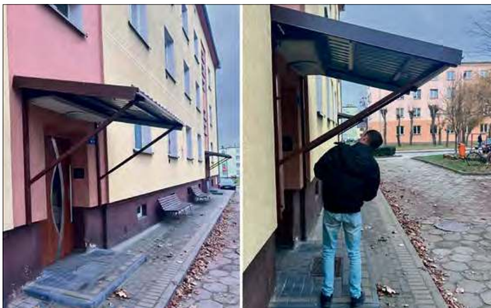
Przesła podtrzymujące daszek są zamontowane w taki sposób, że wchodząc lub wychodząc z klatki schodowej można się w nie uderzyć.
