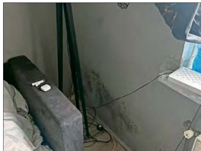
Kobieta załamuje ręce, bo ze ścian zaczęła wychodzić wilgoć i pojawiać się pleśń.
