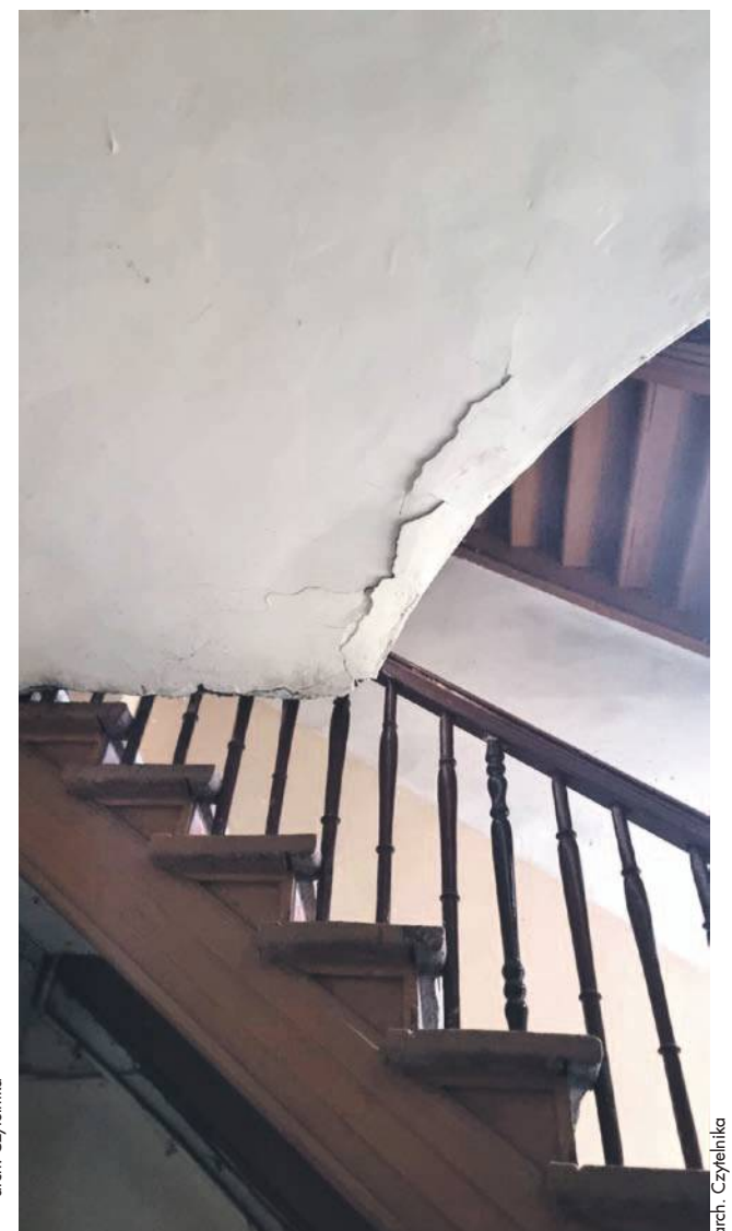
Tak wygląda większość ścian w tej kamienicy
