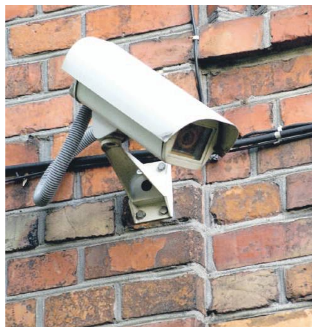
Władze gminy J-L zakładają, że przeniesienie serwerowni do budynku UMIG usprawni pracę monitoringu
