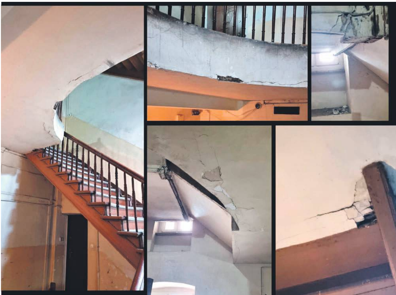
Kamienica przy Placu Zamkowym 25 jest w coraz gorszym stanie, na remonty brakuje pieniędzy. Zarządca obiecał jednak, że w najbliższych dniach te odpadające tynki zostaną naprawione
