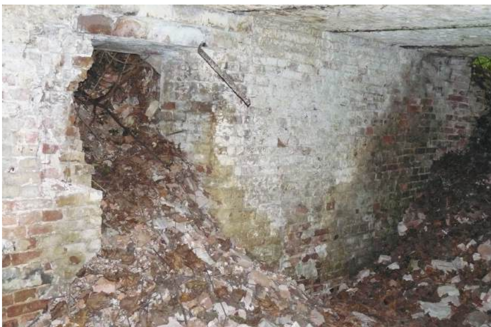
Stan piwnic dużego pałacu w Górze
