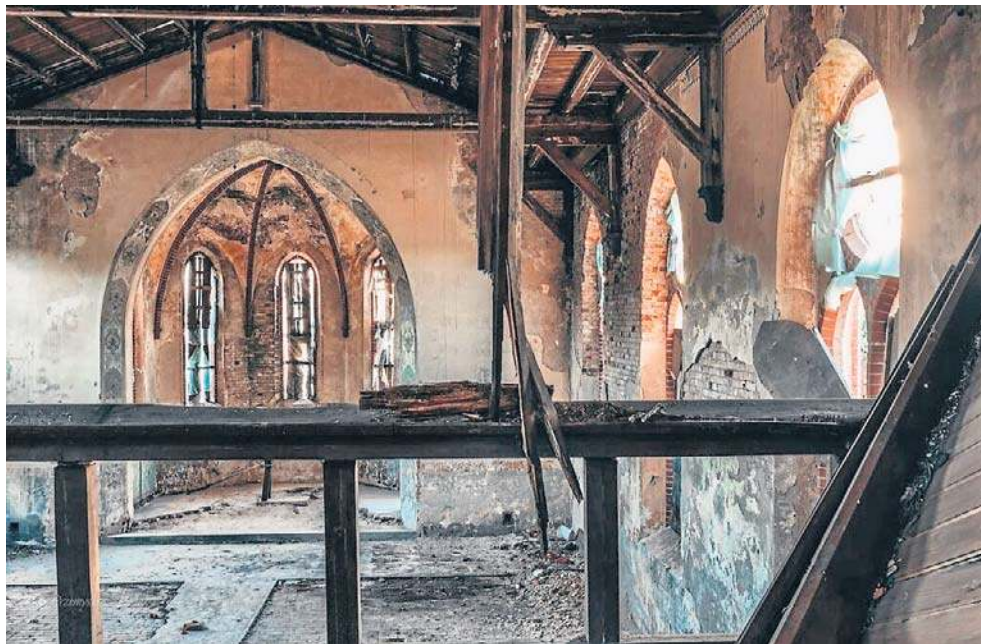
Z tyłu kościoła znajduje się balkon, na którym mógł stać chór albo wierni. Stare drewniane deski rozpadają się
