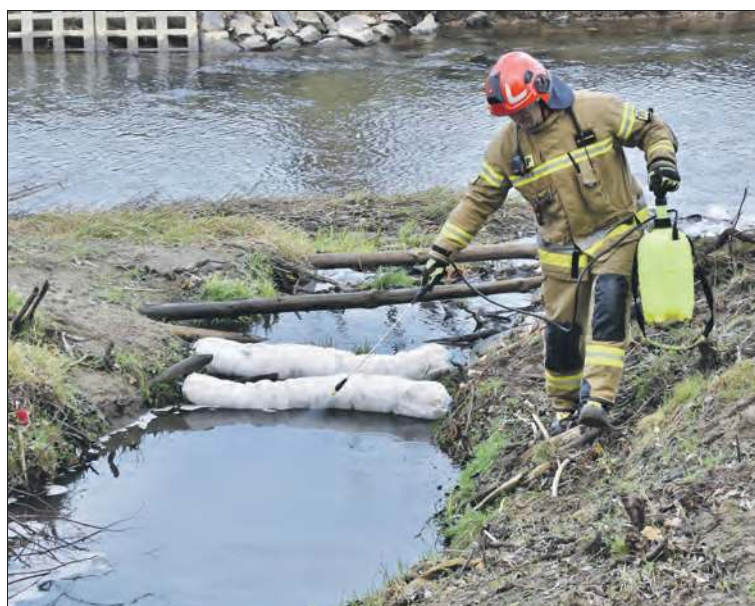
Wyciek zneutralizowali prudnicki strażacy
