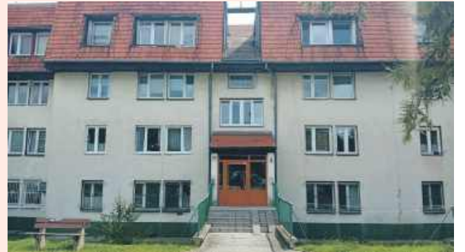
Uszkodzona deska zwisała nad tym wejściem
