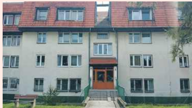
Uszkodzona deska zwisała nad tym wejściem
