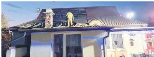
Na naprawę dachu i zakup zniszczonych w pożarze mebli organizatorzy zbiórki chcą zebrać 50 tys. zł.
