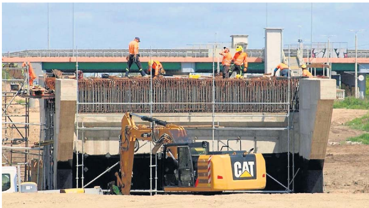
Nowy wiadukt w ciągu trasy N-S jest budowany nad ulicą Gołębiowską. Trwa zbrojenie płyty głównej.
