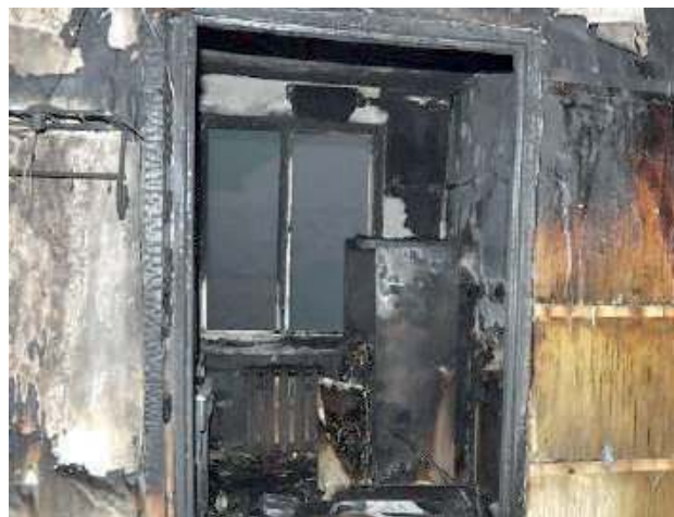
Spaleniu uległo m.in. wyposażenie kuchni, korytarza
