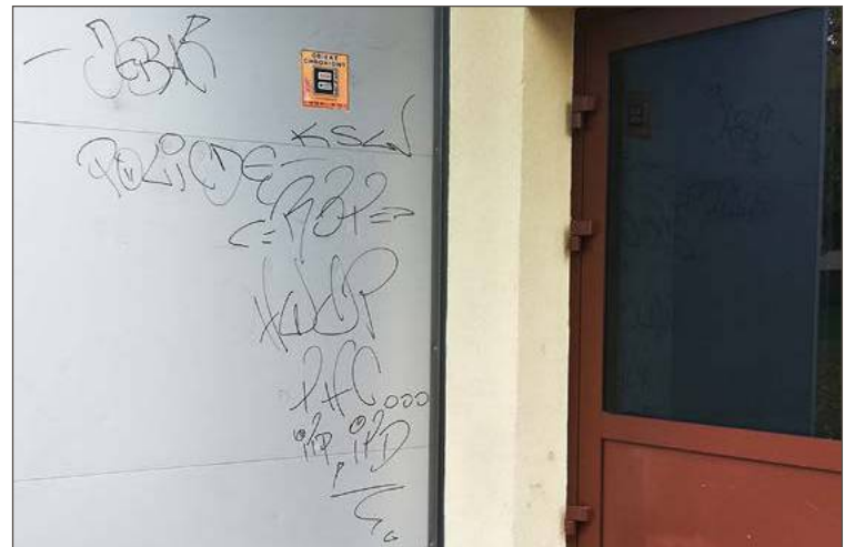
Szyb windy jest regularnie niszczone przez wandalizm.
