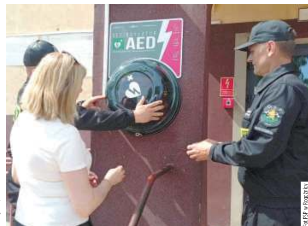
Urządzenie znalazło swoje miejsce na zewnątrz, przy głównym wejściu do szkoły
