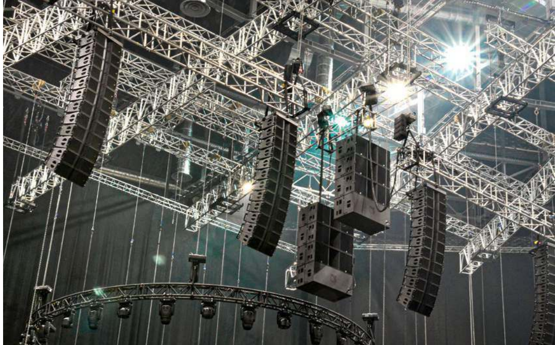
Za odtwarzanie najniższych częstotliwości odpowiadał podwieszony klaster niskotonowy, złożony z 8 subwooferów KS28 w układzie schodkowym cardio.
