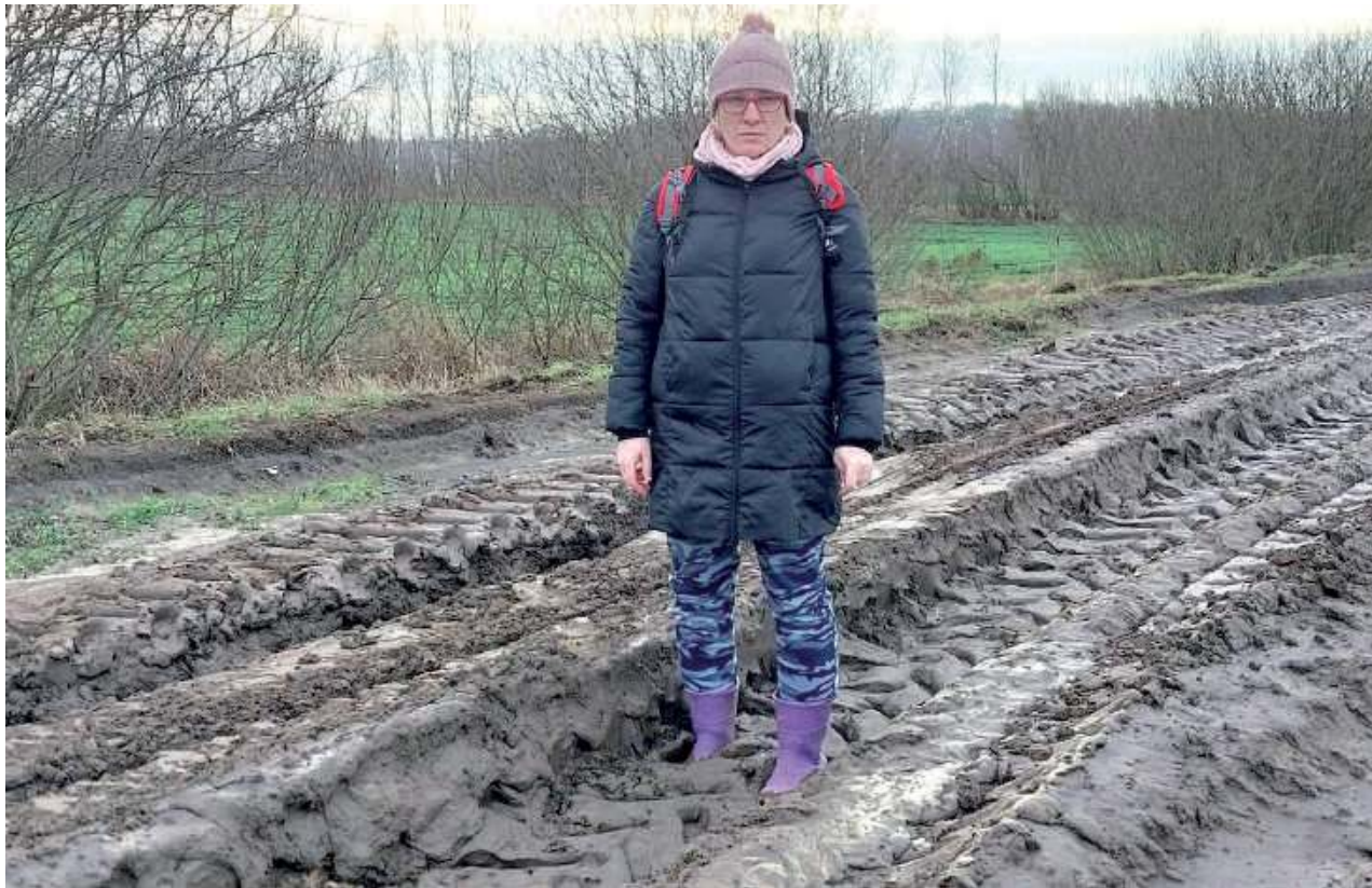
Tak wyglądała droga gminna w trakcie roztopów
