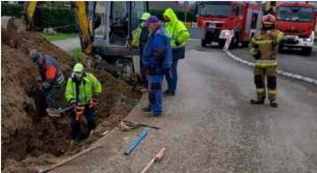
Do uszkodzenia gazociągu doszło podczas prac ziemnych
