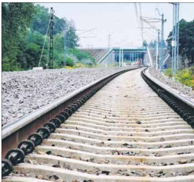
Skutkiem wykolejenia była blokada jednego czynnego toru
