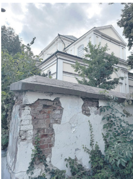
Mur kolegiaty przed rewitalizacją...
