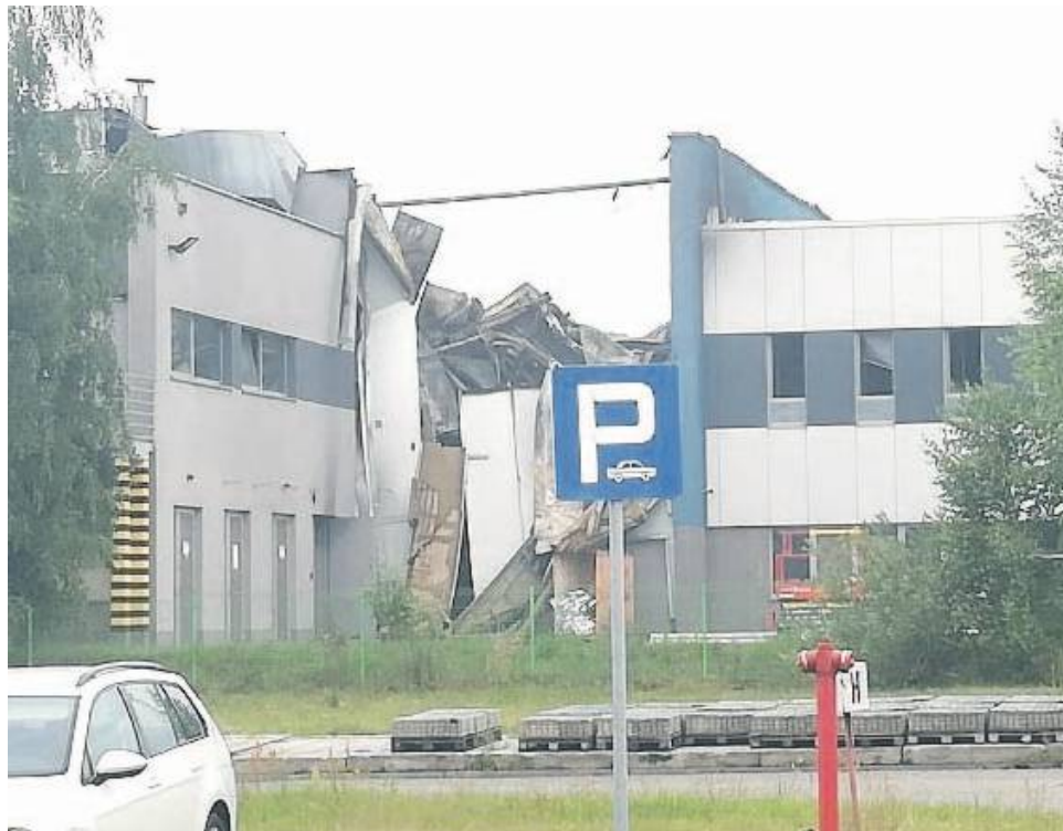
Część dachu się zawaliła
