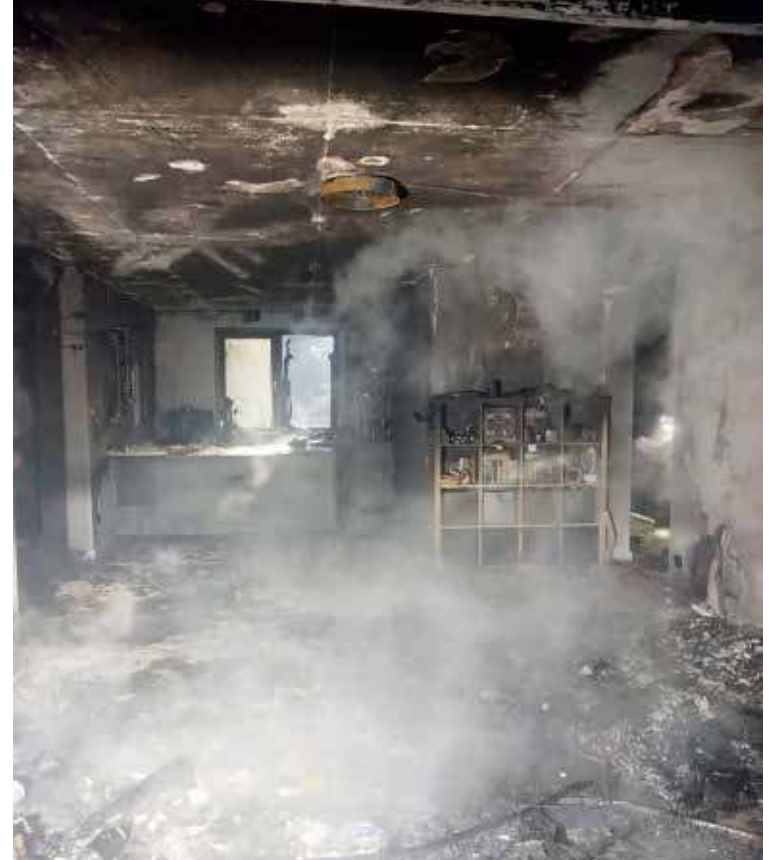
Zniszczeniu uległ m.in. salon (fot. OSP Rurzyca)
