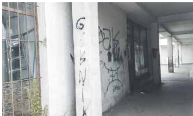
Kiedyś Wigoland był minicentrum handlowym w Strzybnicy. Teraz większość lokali stoi pusta i całość jest coraz bardziej zaniedbana
