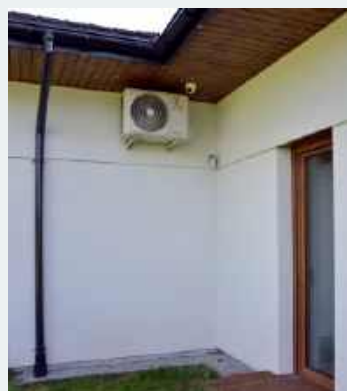
❶ Jednostkę zewnętrzną typu split zamontowano w zacienionym miejscu.
