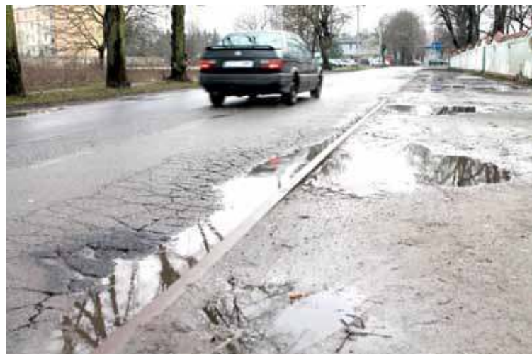
Droga na ul. Głównej. Na jezdni są spore dziury
