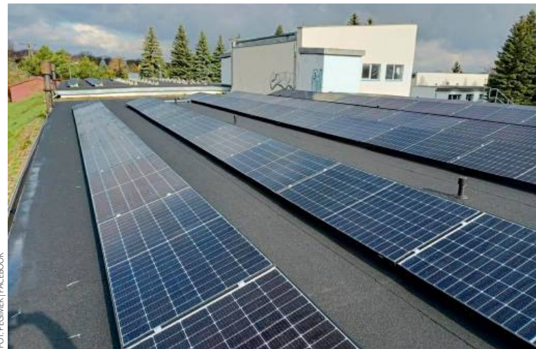
Panele na dachu budynku Zakładu Wodociągów i Kanalizacji już produkują prąd
