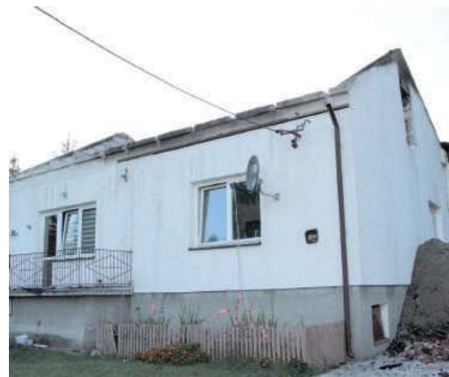
Ogień zdążył pochłonąć część dobytku. Spłonął dach, strych, część mieszkalna domu została zalana wodą podczas gaszenia pożaru
