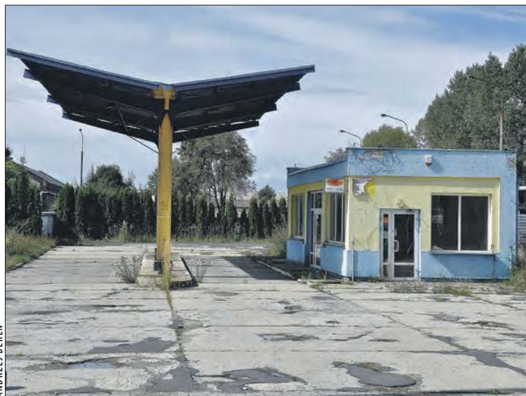
Była stacja paliw przy ul. Nyskiej od lat straszy wyglądem
