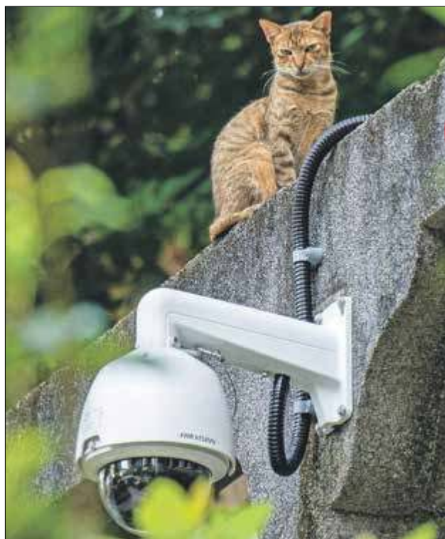
Monitoring zewnętrzny to rozwiązanie dla tych, którzy obawiają się włamania i kradzieży. System pozwala na obserwację ogrodu, strefy wejściowej oraz innych niewrażliwych punktów na posesji
