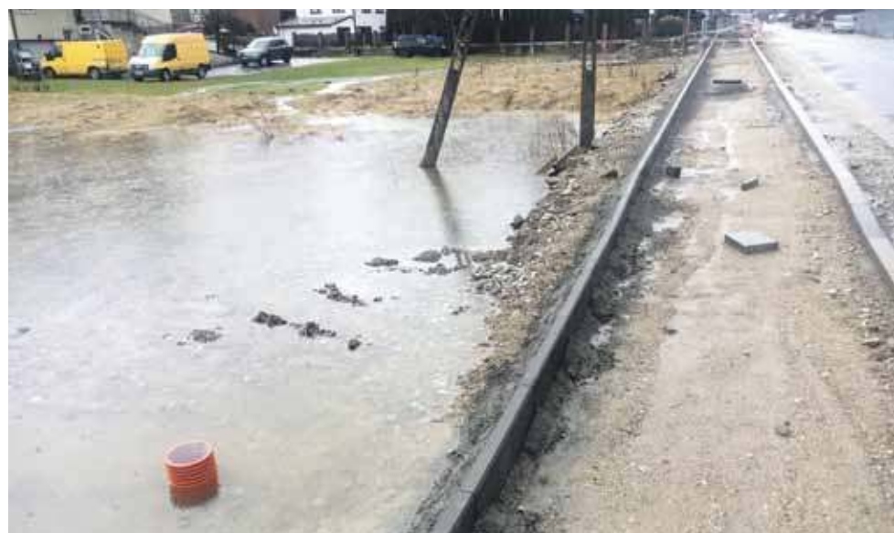
- Moja posesja przy dużych opadach deszczu jest zalewana przez wodę - mówi mieszkaniec Ochotnicy Górnej.
