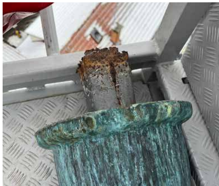
Już po demontażu iglicy można było zaobserwować korozję, czyli źródło problemu
