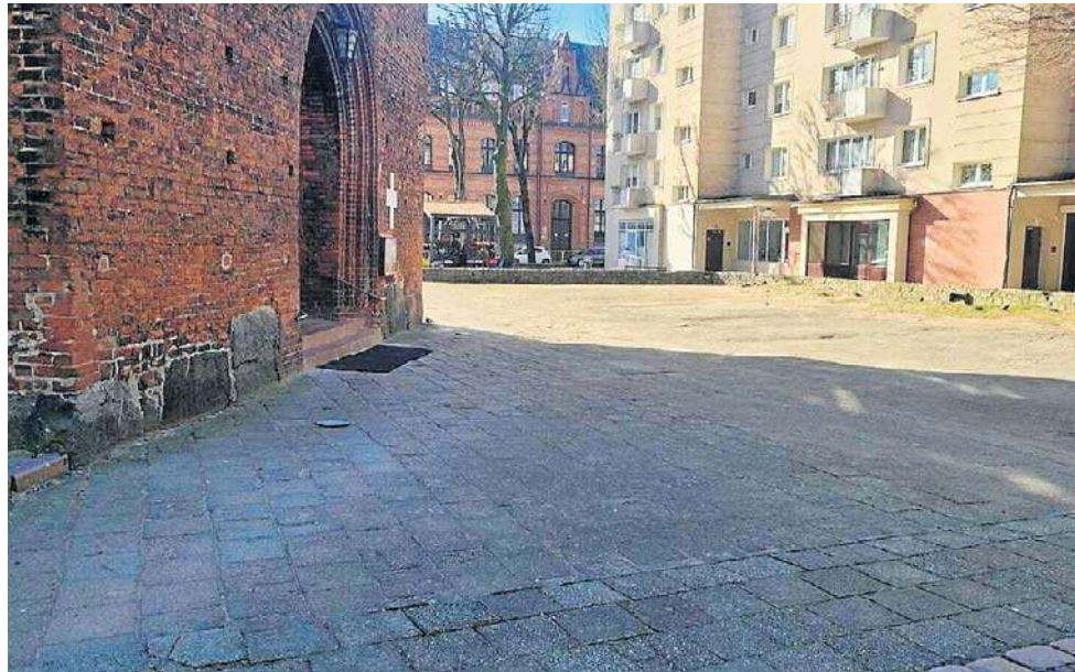
Plac przy kościele mariackim w Słupsku. Obszar pokrywają stare i zniszczone płyty chodnikowe, które estetyką znacznie od nawierzchni sąsiedniej ulicy Nowobramskiej
