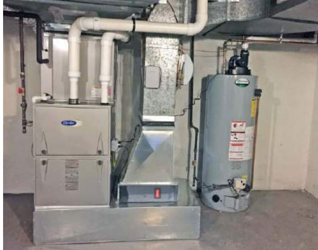
2. Kotłownia systemu z wymuszonym obiegiem powietrza
