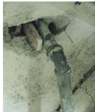
Rura kanalizacyjna z jednego z lokali usługowych
