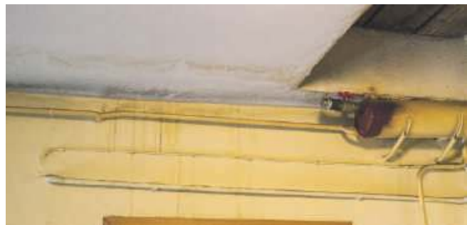
Fragment zalanej klatki schodowej
