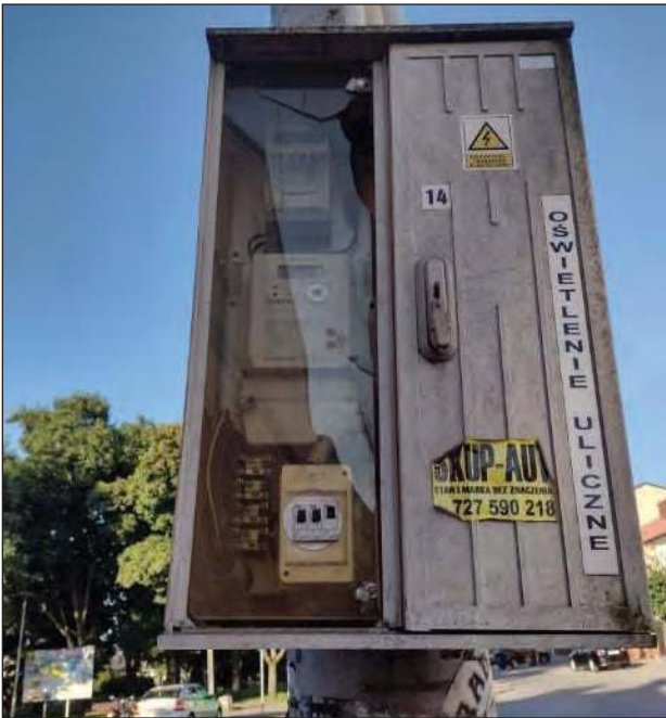
✚ Zniszczona skrzynka znajduje się obok wlotu ulicy Warszawskiej do ronda w rynku
