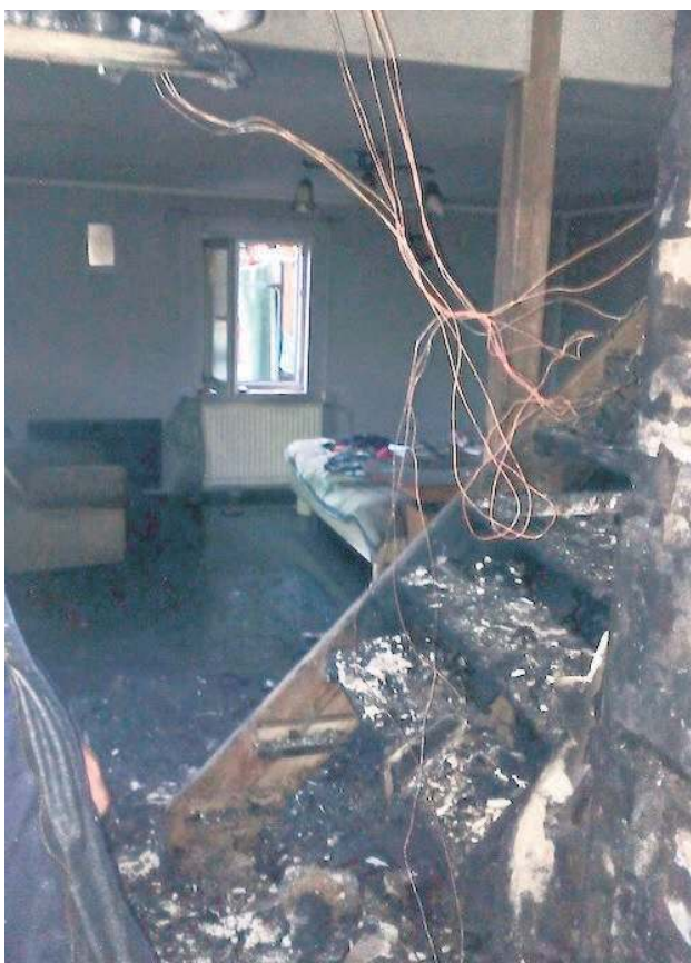
Spaleniu uległy drewniane elementy budynku oraz schody.
