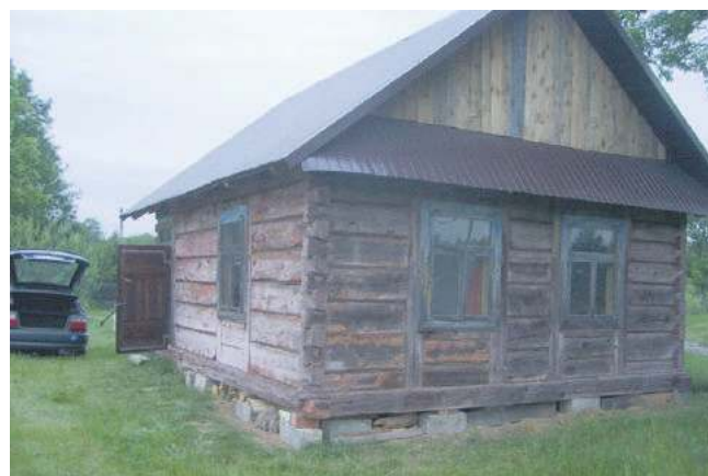
Pan Tomasz był przekonany, że skoro nie stawia chałupy na fundamentach, tylko na luźnych pustakach, to nie potrzebuje pozwolenia na budowę.
