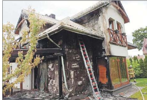
Pożar objął drewniany taras, ściany budynku i poddasze
