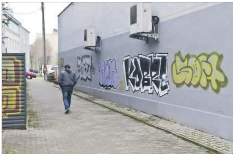
Tak wygląda ściana budynku przy ul. Kolejowej.
