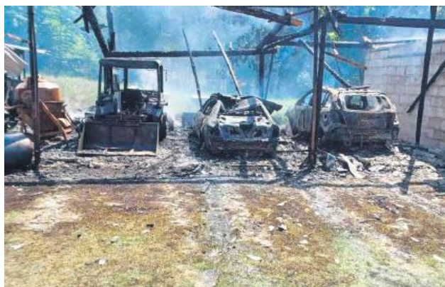
Prawdopodobną przyczyną pożaru było zwarcie instalacji elektrycznej w jednym z samochodów osobowych.
