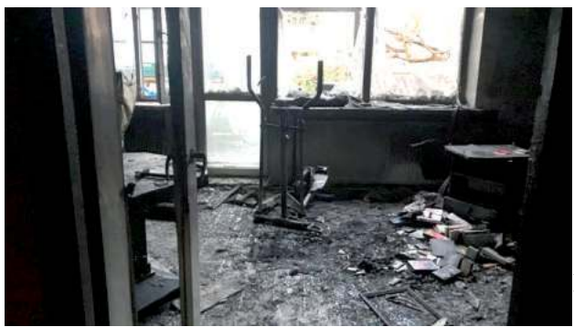
Pomieszczenia na parterze są doszczętnie spalone
