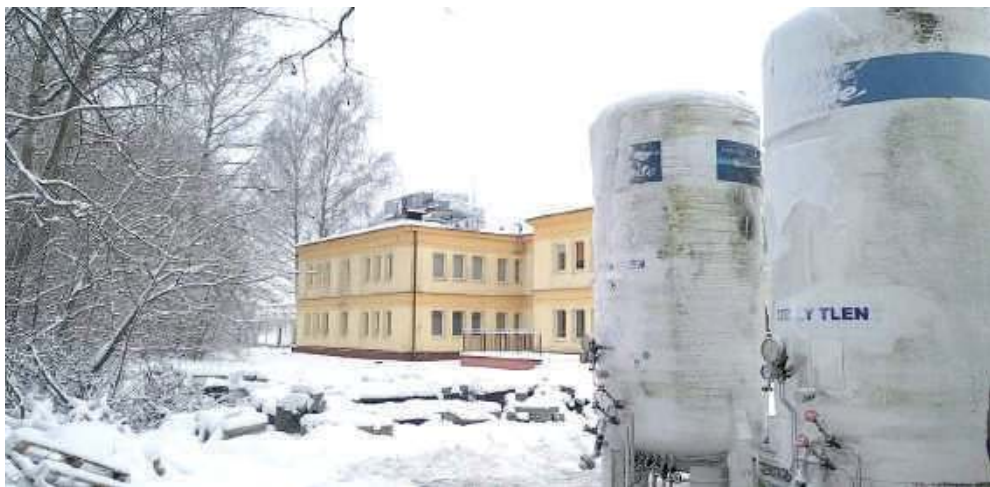
Na terenie szpitala w Poniatowej stanęły dwa zbiorniki na tlen ciekły. Każdy o pojemności 3300 litrów
