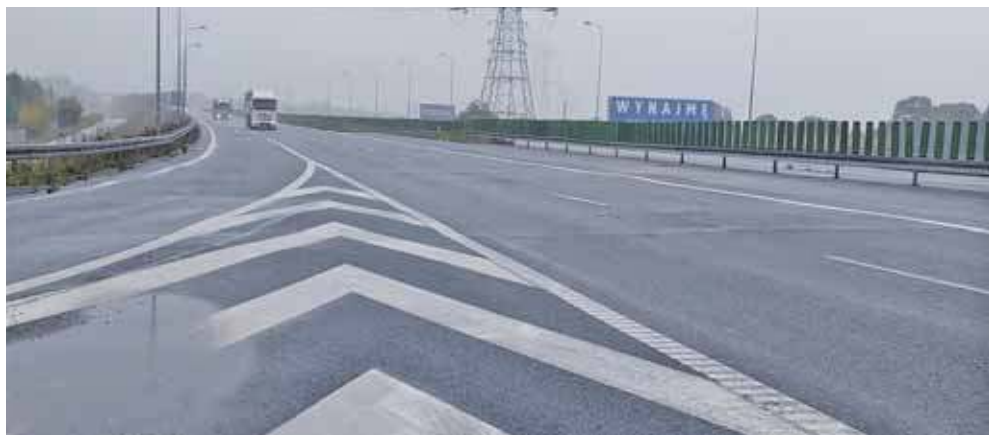
Pofałdowany odcinek autostrady A1
