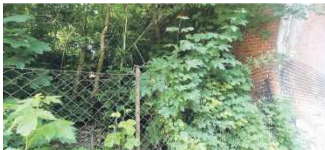
Wiadukt i jego nasypy zarastają krzewy i drzewa
