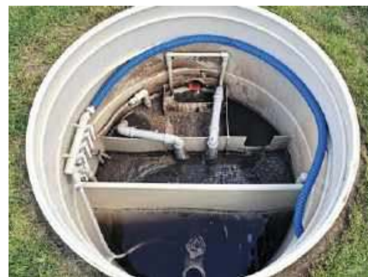
➔ Wnętrze oczyszczalni biologicznej. EKO HOUSE
