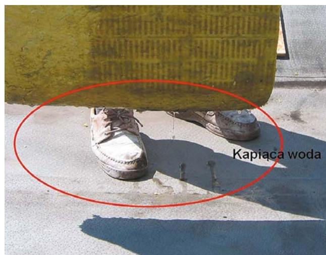
FOT. Płyta sztywnej wełny skalnej wyjęta z dachu pływalni, w której paroizolacja była wadliwie (bo nieszczelnie) zamontowana. Odkrywkę wykonano po 3 latach;
