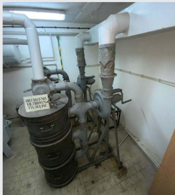
Fot. 2 Pomieszczenie wentylatori z urządzeniami umożliwiającymi napęd ręczny; lokalizacja urządzeń jest nietrafna – korzystanie z nich w sposób efektywny będzie utrudnione
