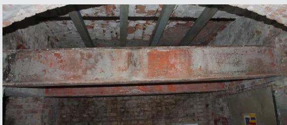
Fot. 5 Belki stalowe stropowe w pomieszczeniu schronu z lat 50. XX w. – wzmocnienie zostało rozebrane z uwagi na konieczność zabezpieczenia stropu międzykondygnacyjnego
