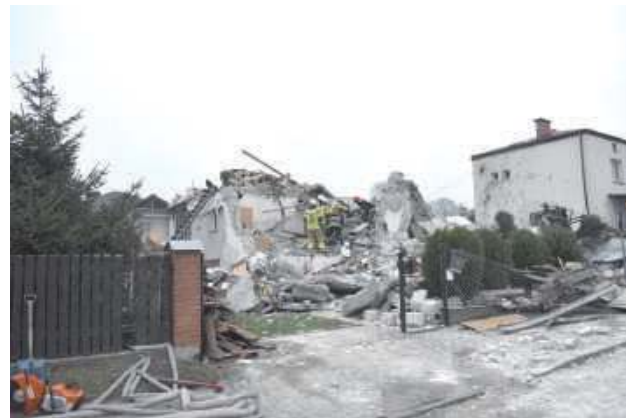
Było jeszcze ciemno, kiedy przed godz. 6 okolicę na nogi postawił potężny wstrząs. Wkrótce okazało się, że w piętrowym domu jednorodzinym wybuchł gaz. Budynek został kompletnie zniszczony
