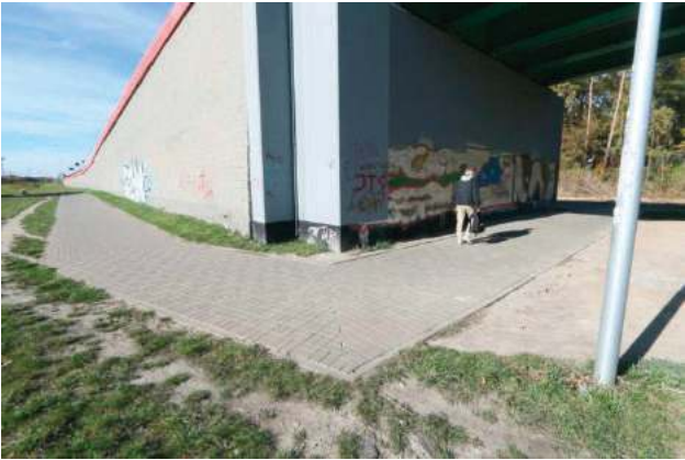
O istnieniu problemu świadczy wyjeżdżona przez rowerzystów ścieżka wzdłuż chodnika przy wiadukcie na ulicy Sobieskiego
